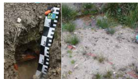
Obr. 5. Poškozený a odhalený drén (foto: archiv VÚMOP a Z. Kulhavý)
